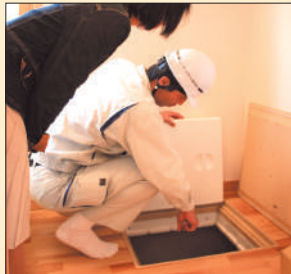
●蓄熱式温水床暖房の定期点検風景。
